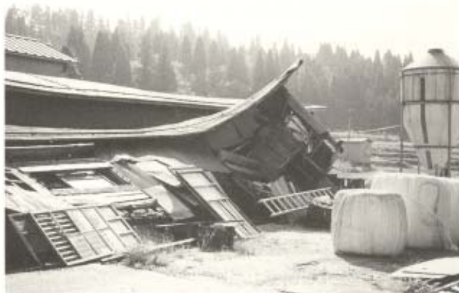
地震で倒壊した牛舎(北魚沼郡川口町)
